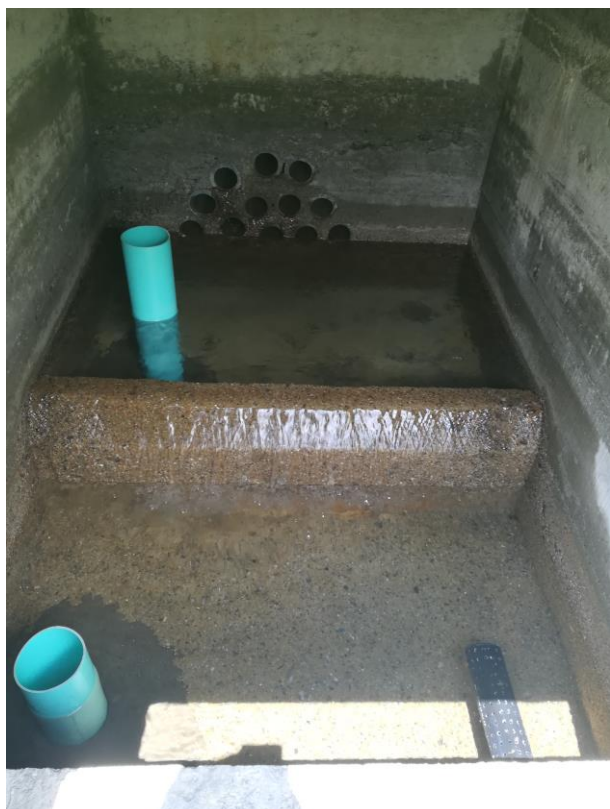
Illustration 15 : Ouvrage de captage (photographie : CEREG)
